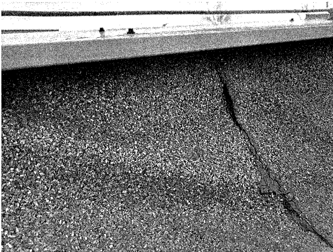
5. Widok odspojonych połączeń papy na murkach attykowych
