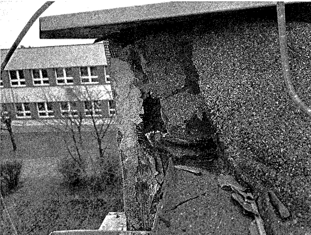
8. Widok uszkodzonej ściany attykowej od strony wschodniej
