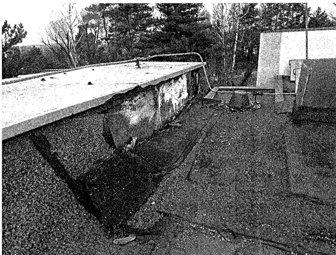
2. Widok uszkodzonego fragmentu muru attykowego od strony zachodniej
