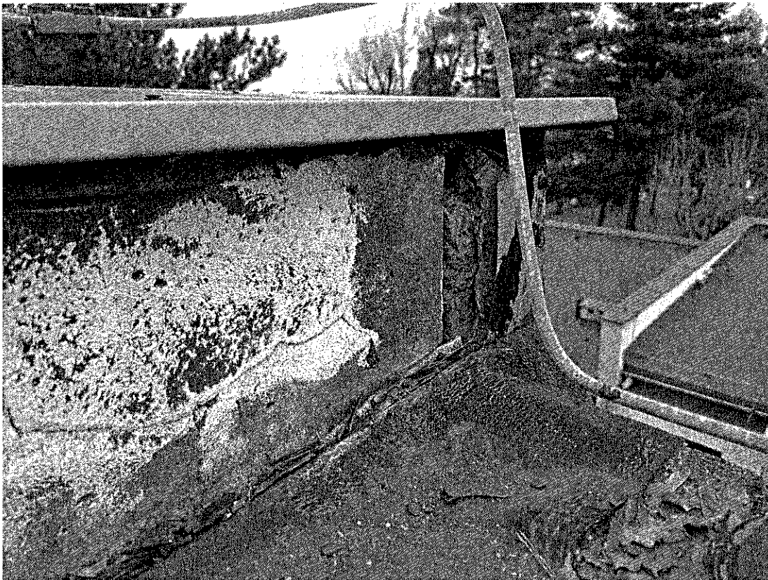
3. Widok uszkodzonego fragmentu muru attykowego
