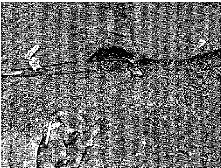
11. Miejscowe uszkodzenia pokrycia
