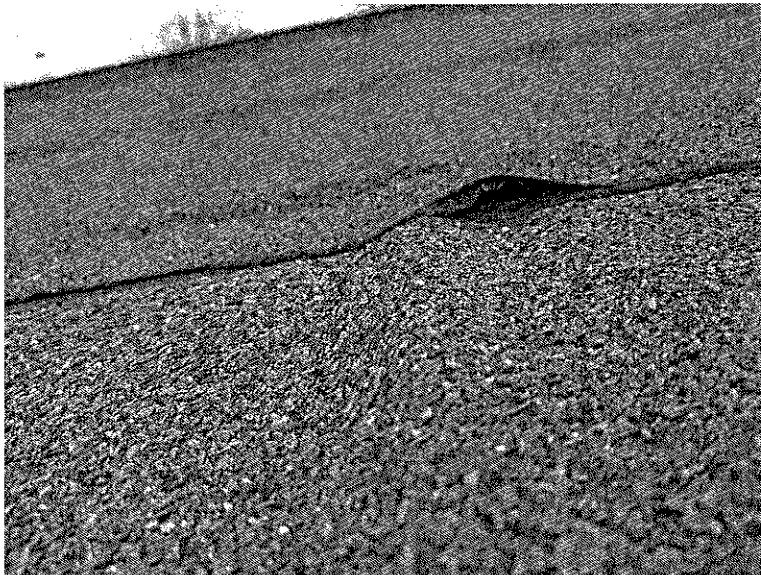
10. Miejscowe uszkodzenia pokrycia
