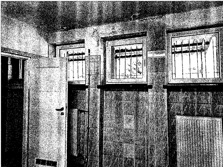
14. Widok zacieków w szatni damskiej
