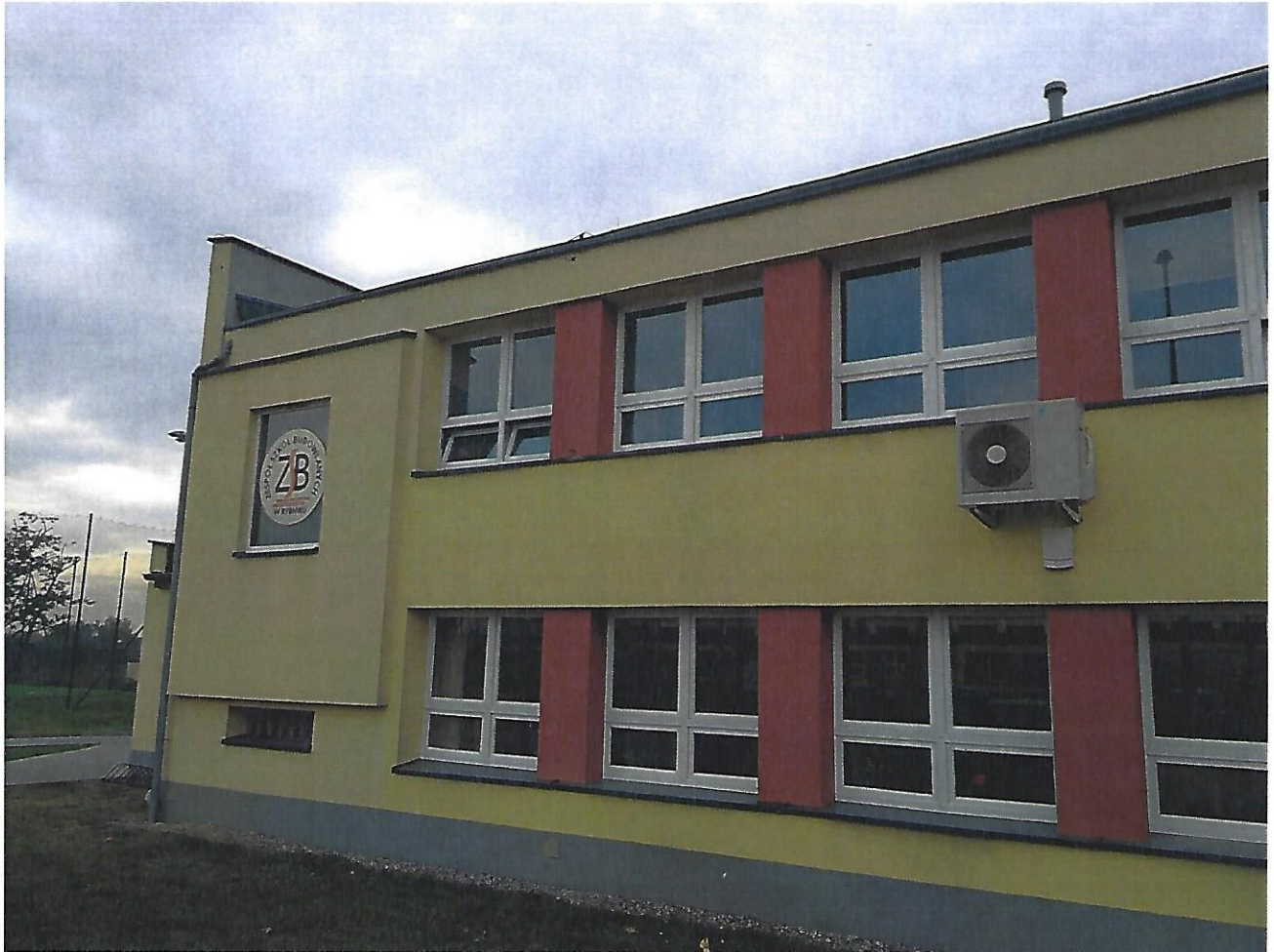
Fot. 5 Miejsce nieszczelności rynien na połączeniach. Wykonać roboty uszczelniające na całej długości rynien, udrożnić spusty i rynny z niwelacją spadków.
