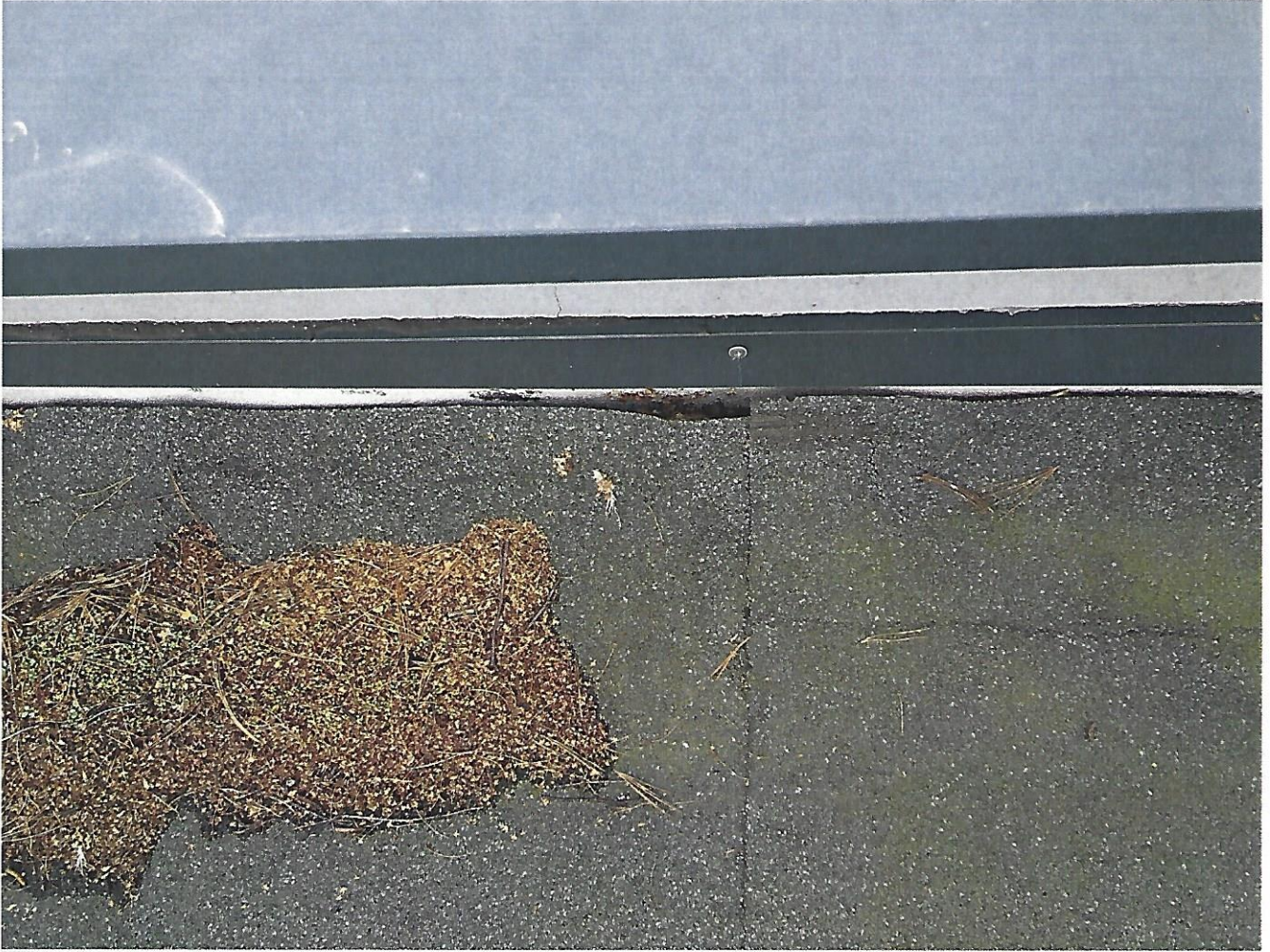
Fot.1 Brak wywinięcia papy na murek – sala gimnastyczna.
