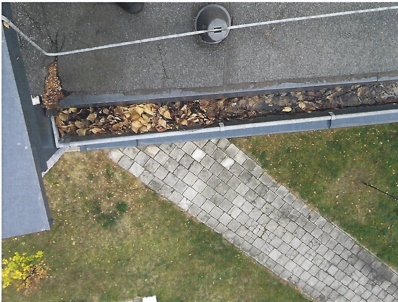
Fot.3 Niedrożne rynny i rury spustowe – sala gimnastyczna.
