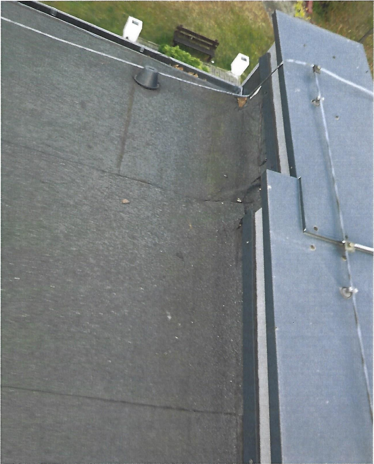
Fot.2 Uszkodzone pokrycie – sala gimnastyczna
