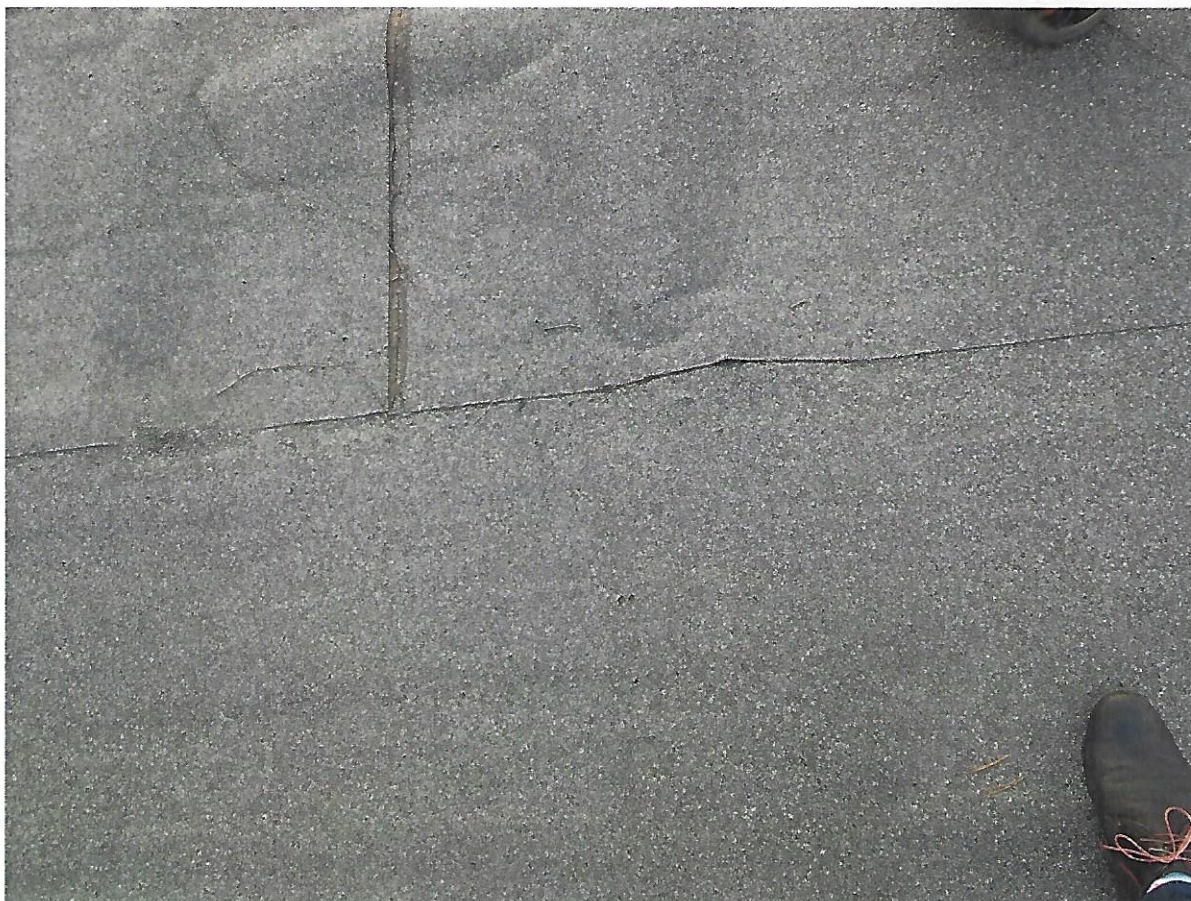
Fot.4 Liczne „pęcherze” i nieszczelności – sala gimnastyczna.
